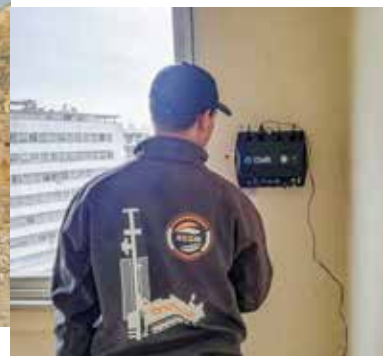
→ Instrumentation et mesures | Installation d'une station de surveillance vibratoire
