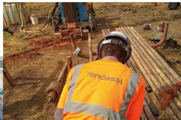
→ Investigations géotechniques | Sondages carottés avec essais SPT et pose de piézomètres pour suivi du niveau d'eau
